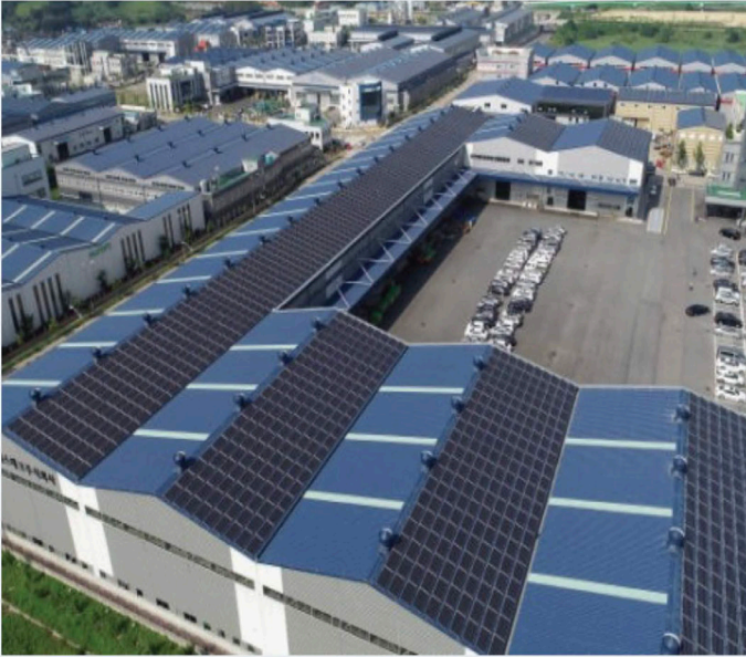
김해 골드루트 산업단지 입주기업 공장 지붕에 설치된 태양광 모습
